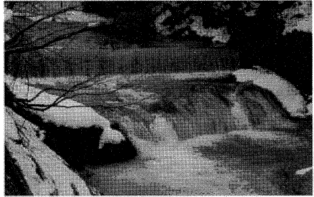
図14 布谷2号床固工とその直下の洗掘状況
